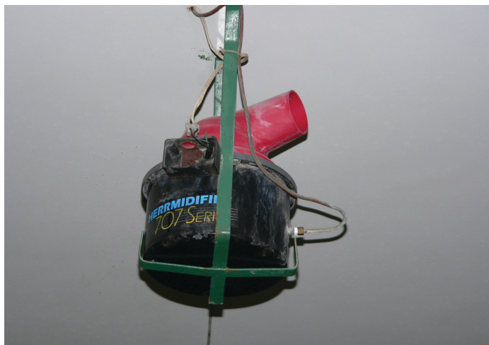
Uma unidade de umidificação de uma câmara fria
