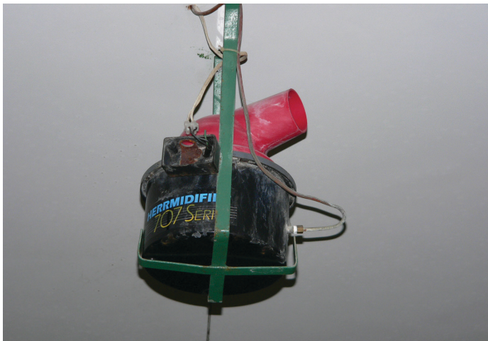
Unidad de humificación en cuarto de almacenamiento
