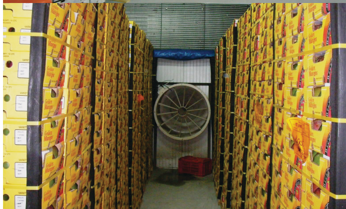
Conductos y túneles de enfriamiento con aire forzado
