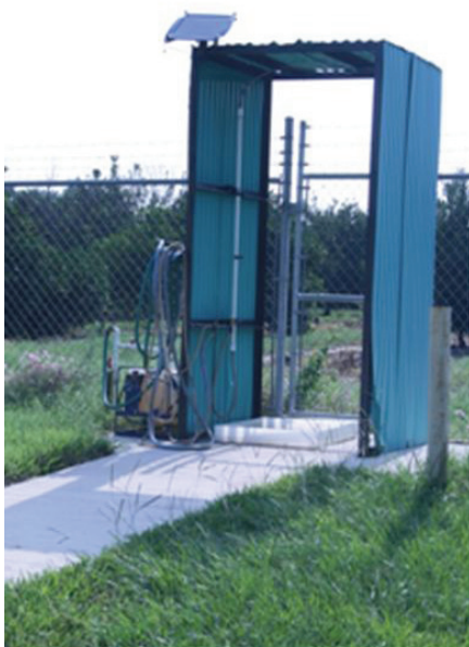
Figure 11a. Estación automática de descontaminación personal.
