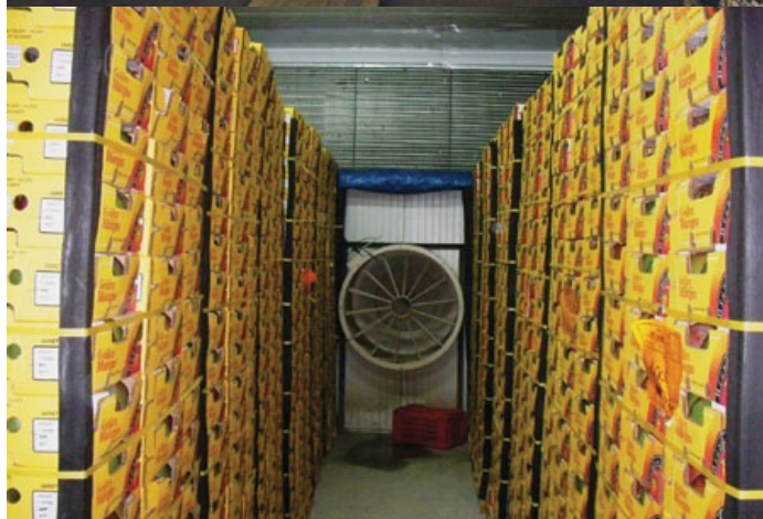
Conductos y túneles de enfriamiento con aire forzado
