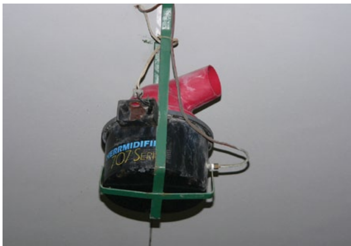
Unidad de humificación en cuarto de almacenamiento
